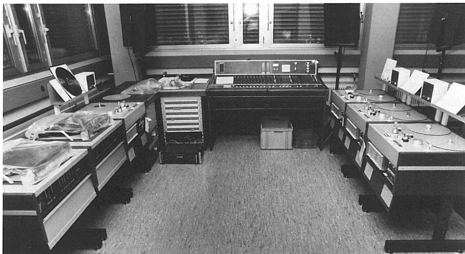
Für Abu Dhabi wurden 8 Studios erstellt. Die Übergabe der Kurzwellenstation – Gemeinschaftsarbeit BBC Baden, STR Zürich und STUDER – erfolgte am 2.12.84 am Ort.
